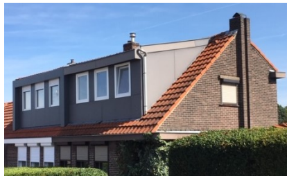
Afbeelding 8 dakkapel voldoet niet
